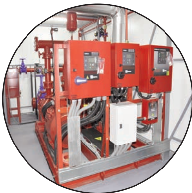
Vista general del Equipo Contra Incendios.
