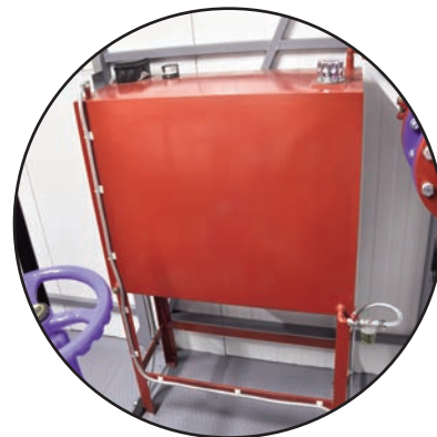
Detalle del depósito.
