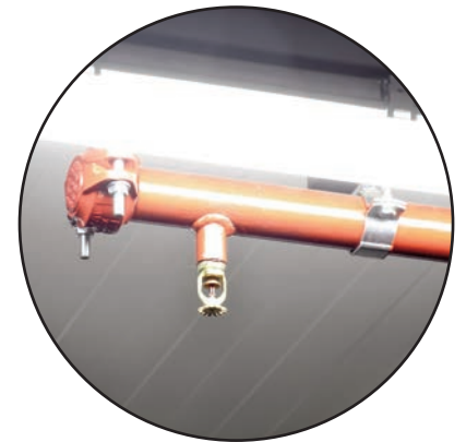
Detalle de rociador.
