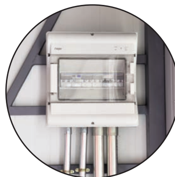
Cuadro eléctrico independiente para alimentación de iluminarias, enchufe de ventilación, ventilador y termostato.
