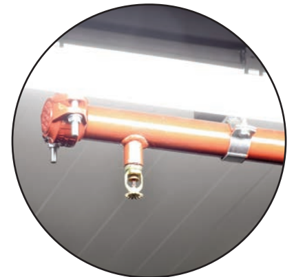
Detalle de rociador.
